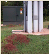
Nidos de hormigas del fuego importadas cerca de equipos eléctricos de exteriores
